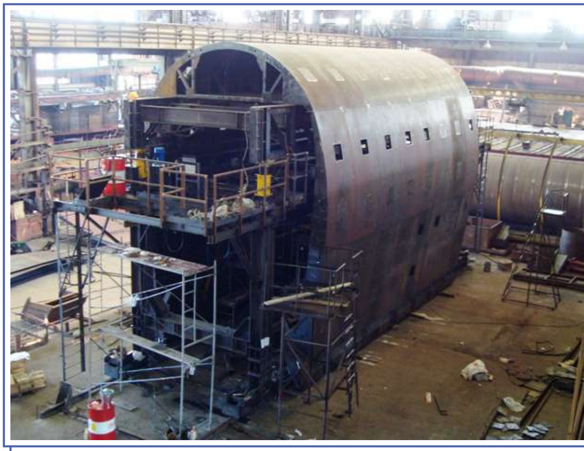
Механизированная опалубка, для возведения монолитной железобетонной постоянной обделки однопутного железнодорожного тоннеля, организующего сообщение Адлер — аэропорт Сочи (Олимпиада 2014)
